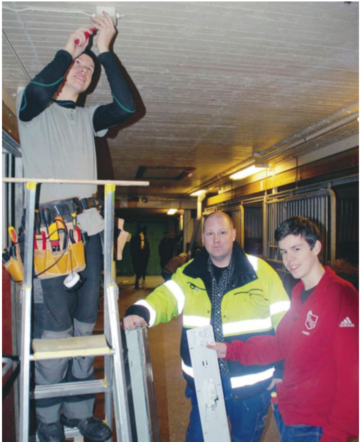
Handledaren och elektrikern Jörgen Carlström informerar Markus Tärleskog om en armatur som skall upp. Under tiden försöker Emil Nilsson få loss en gammal kontakt som kärvar.
